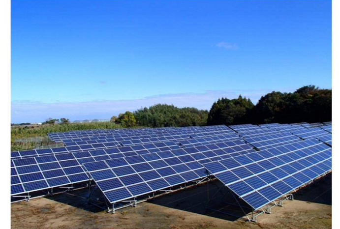
高千穂事業所：東伯郡大栄町高千穂 (H20完了) 太陽光発電所
